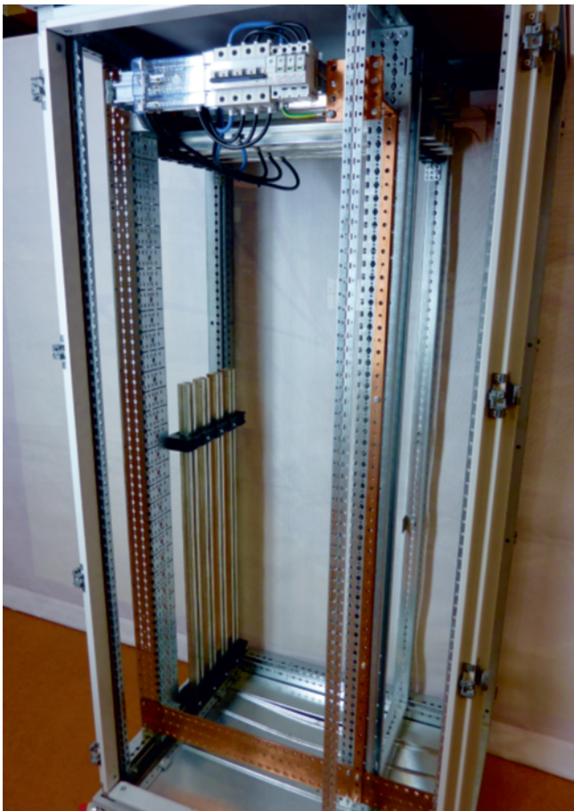
Exemple de réalisation dans une armoire XL 3 avec l'alimentation par le bas de la protection associée au parafoudre.
