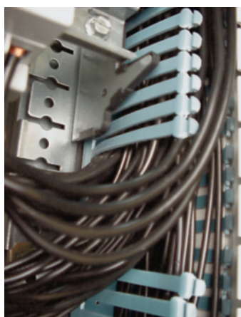
Circulations horizontales "à l'air libre", seuls les conducteurs verticaux sont collectés en goulottes : cas de pose colonne 2 comme ici, le taux de remplissage de la goulotte verticale est important : cas de pose colonne 1
