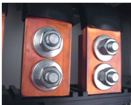
Raccordement d'une barre 50 x 10 par 2 vis M12 réf. 0 374 65 avec rondelles larges intégrées
