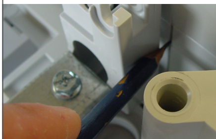
Utiliser les supports des borniers comme guidage des tracés
